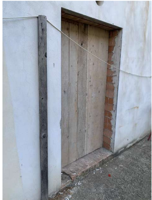
FOTO N.12 porta chiusa su vano scala condominiale
